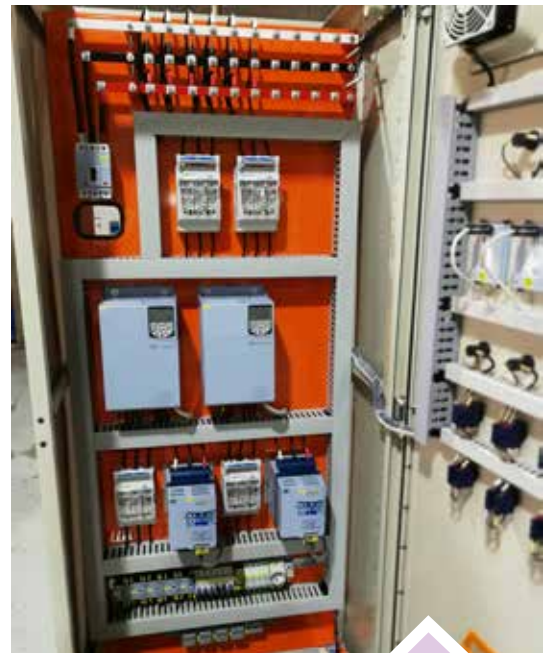
Arranque y Protección de Bombas de 15HP con Convertidores de Frecuencia CFW500 y Soft Starter SSW07 Aplicación: Industria Farmacéutica
